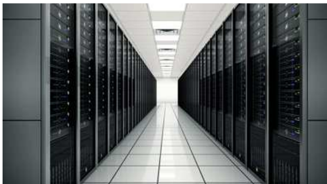
Figure 1: Rangées de cabinets dans un centre de traitement (Incript, 2016)
